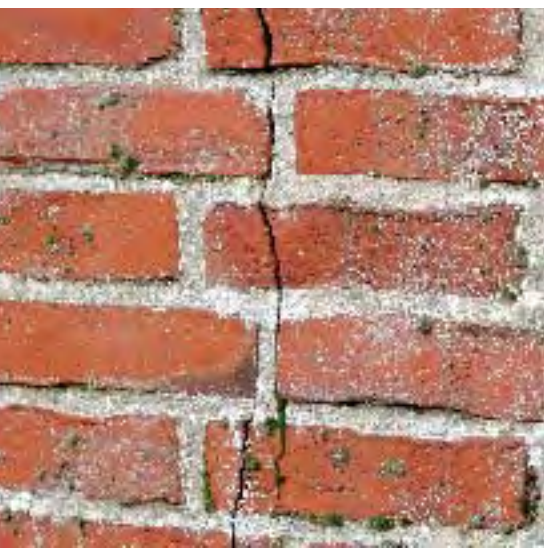
Ikke underligt at beboerne klager over fugtige vægge.
