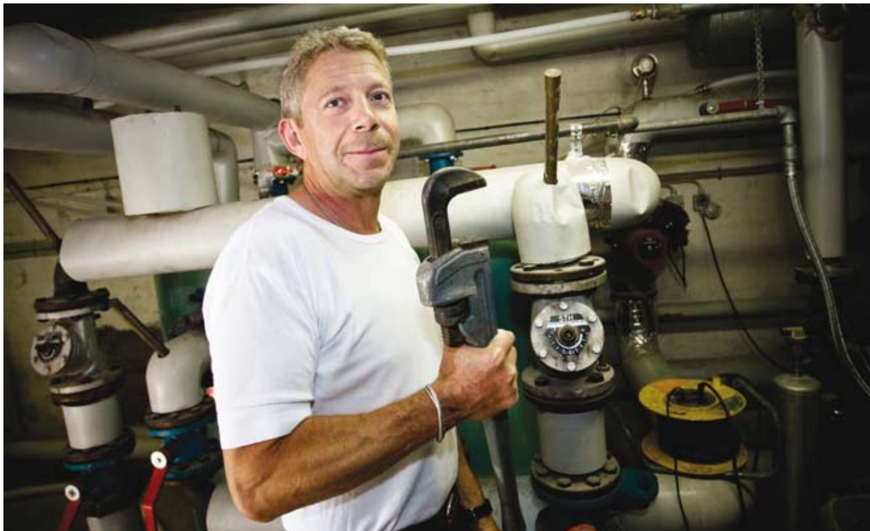
Nærumvænge er den første afdeling blandt Boligkontorets medlemmer, der har gennemgået Danfoss-programmet Energy-trim - et tjek, der skal sikre optimal drift af varmeanlægget. På billedet: Nærumvænges ejendomsmester Steen Pedersen.
